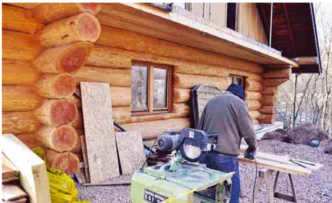
Auch der Innenausbau des nächsten Ferienhauses nähert sich bereits dem Ende. Deutlich erkennbar ist die außergewöhnlich rustikale und natürliche Bauweise in Douglasien-Stammholz.
